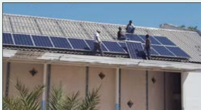
Djibouti : panneaux solaires sur le Centre de formation de l'Église protestante. Il développe une formation à cette technique.
