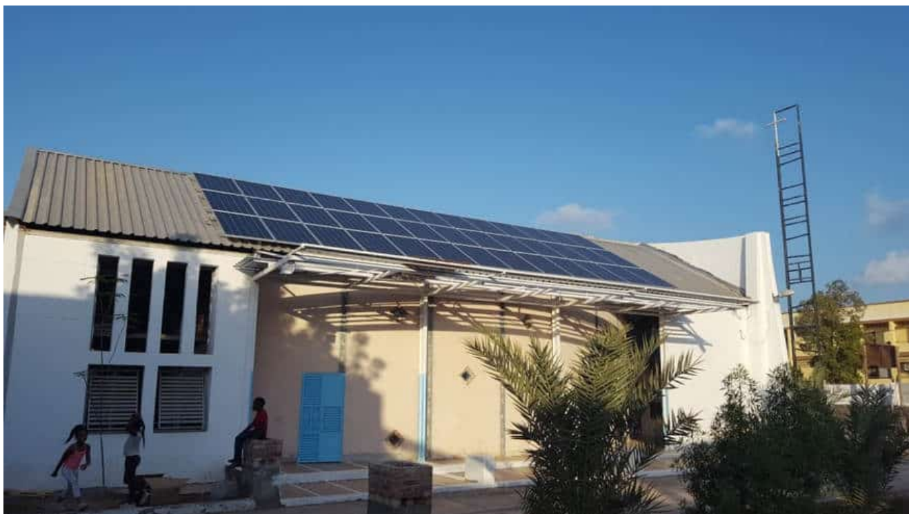
Panneaux solaires installés par l'EPED à Djibouti © EPED
