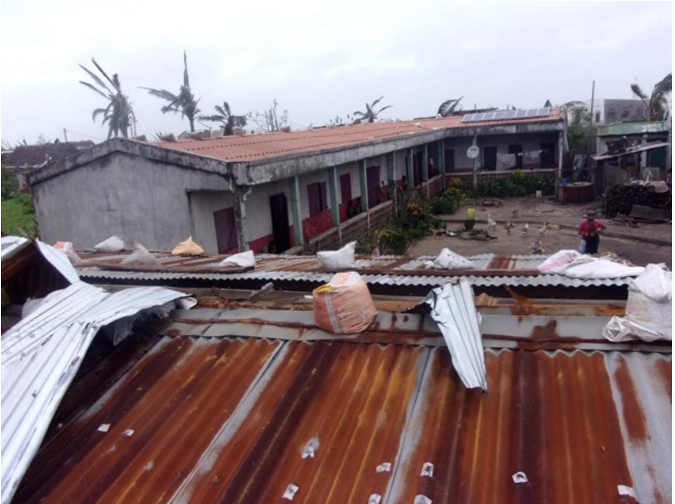
Dégâts du cyclone Batsirai au niveau de la nurserie du centre Akany Fanantenana, à Mananjary © La Cause
