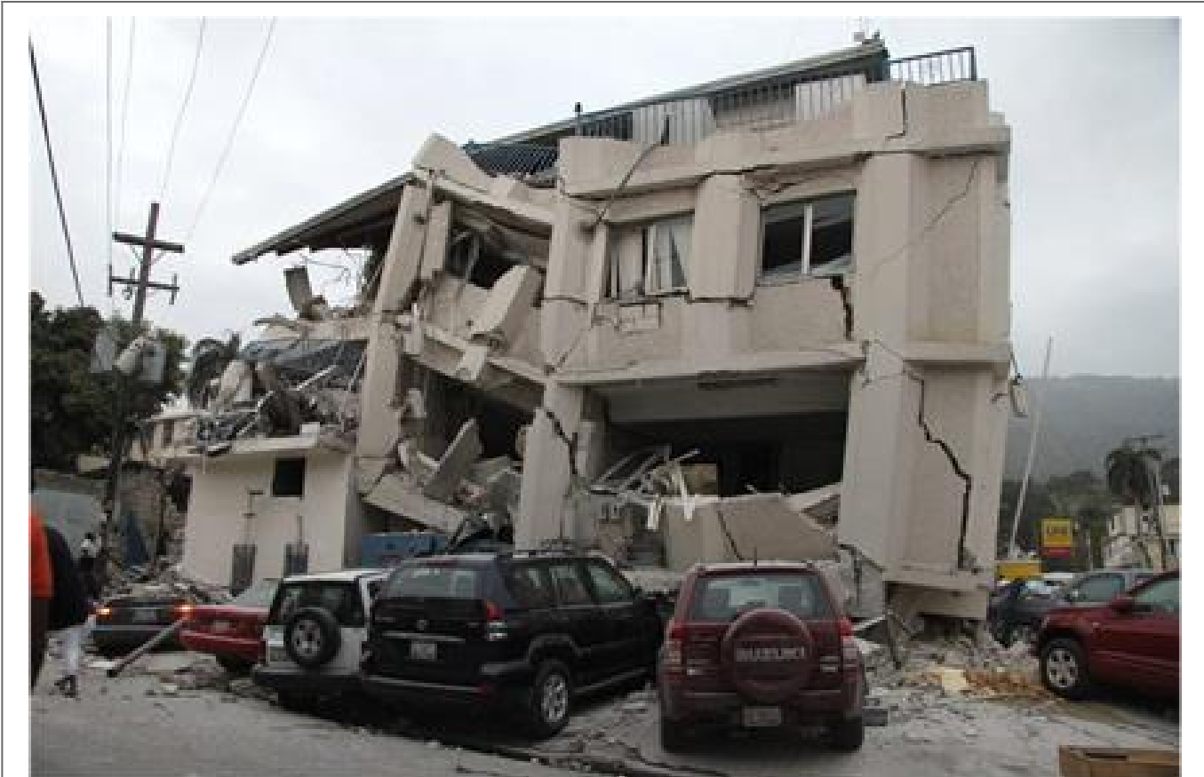
Bâtiment endommagé par le séisme © FEPH
