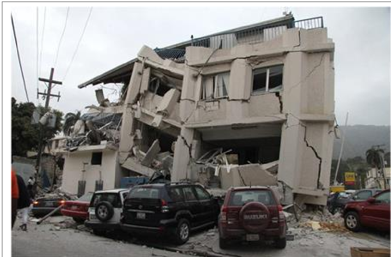
Bâtiment endommagé par le séisme © FEPH
