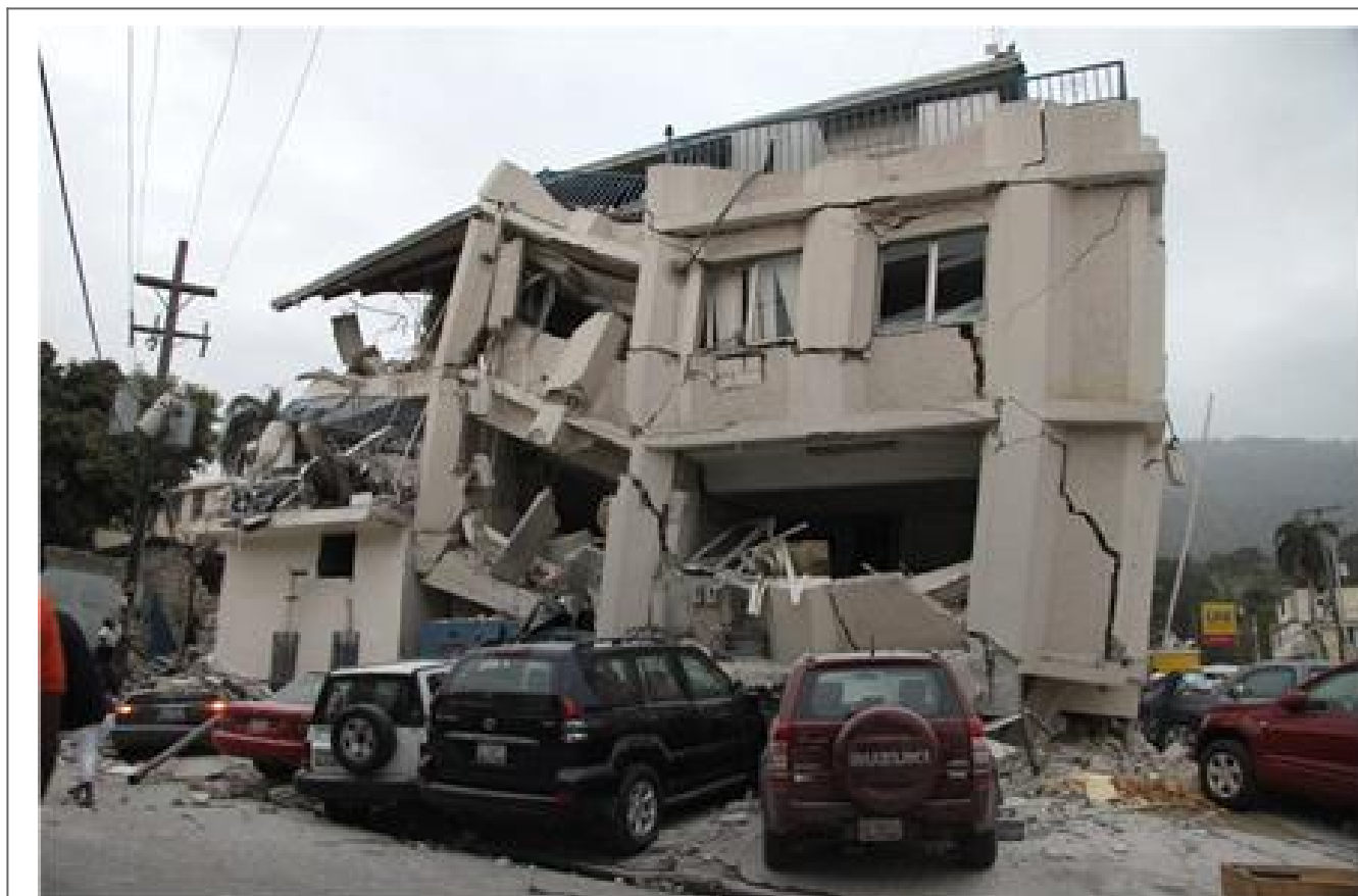
Bâtiment endommagé par le séisme © FEPH
