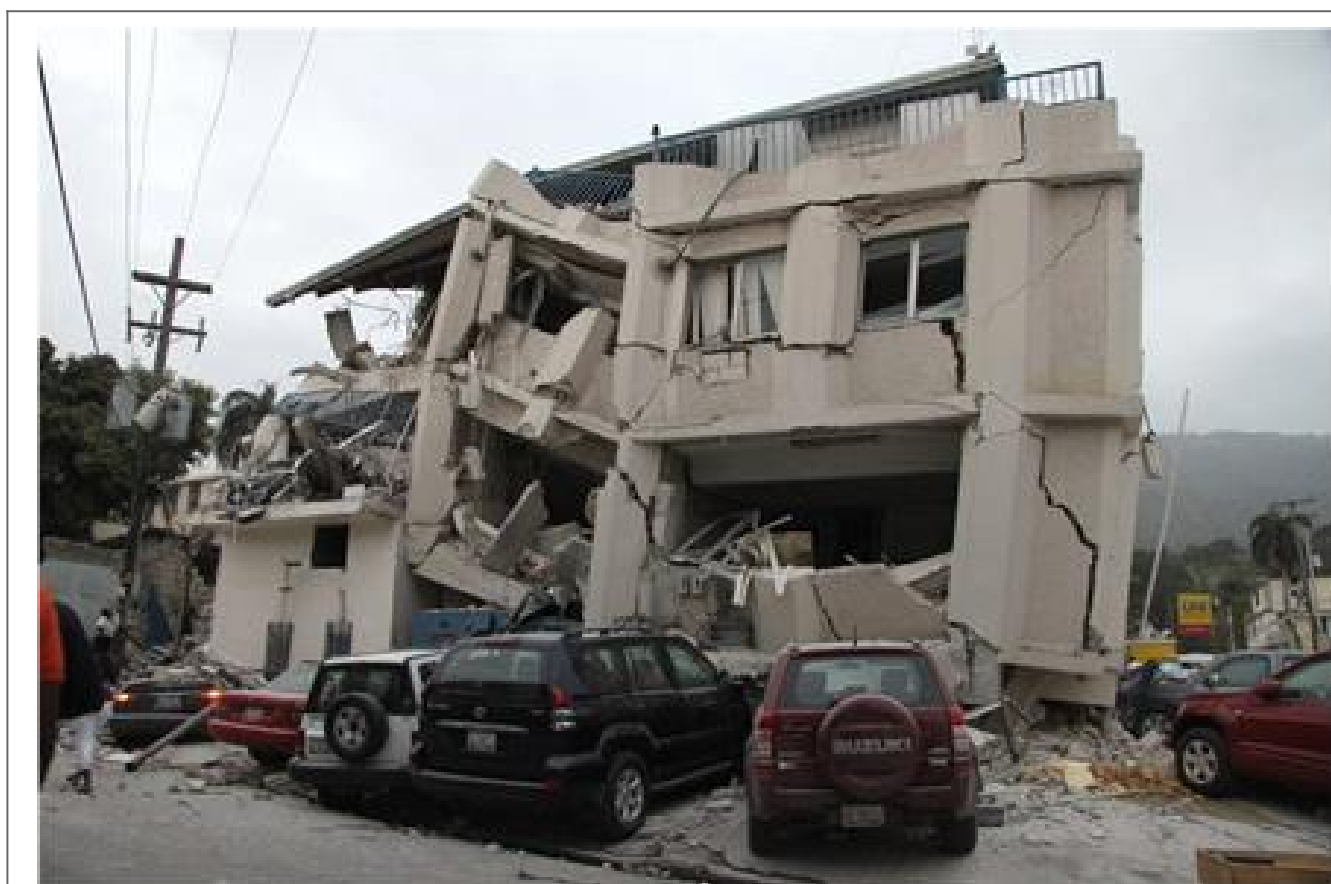
Bâtiment endommagé par le séisme © FEPH
