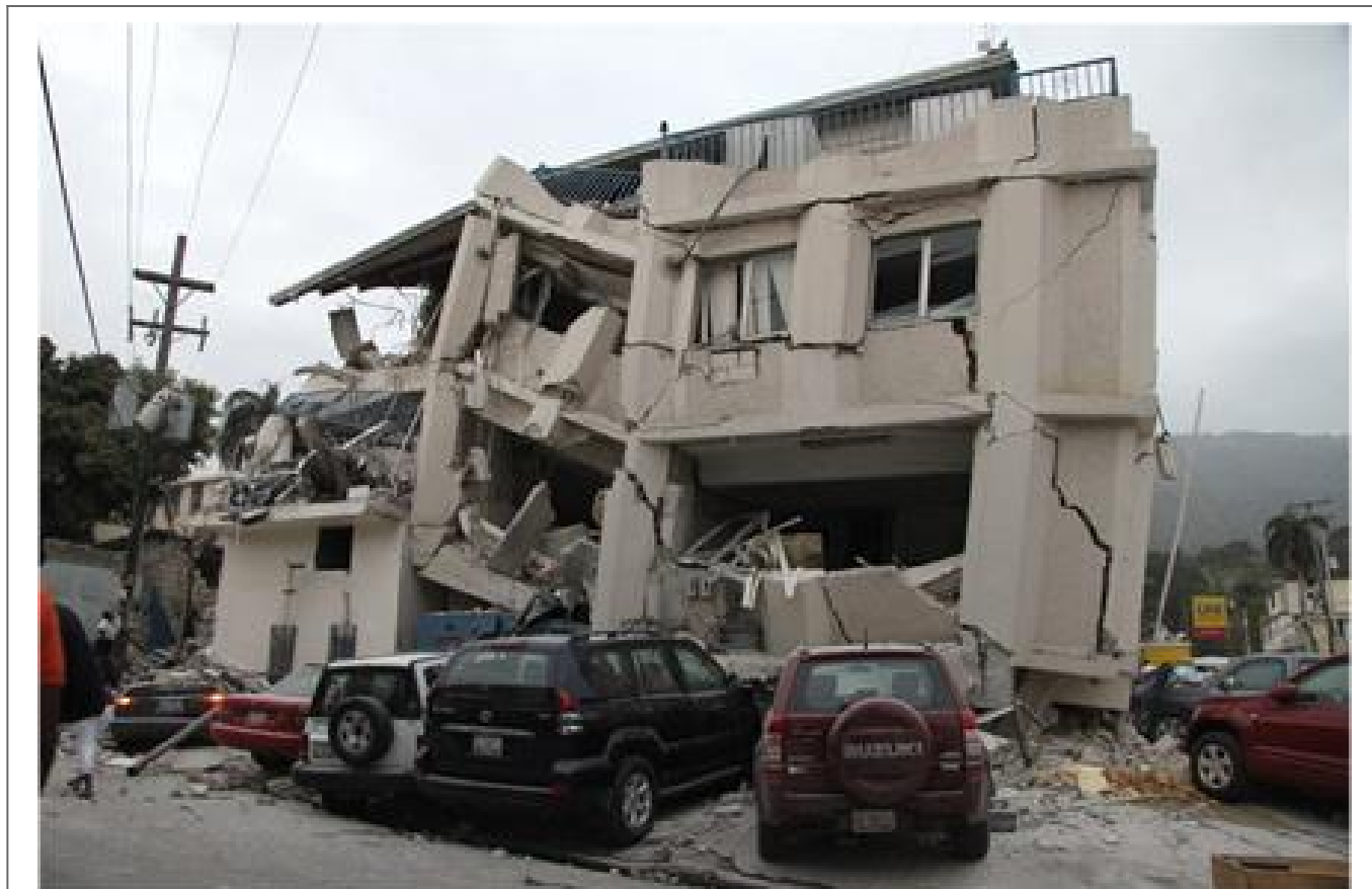
Bâtiment endommagé par le séisme © FEPH
