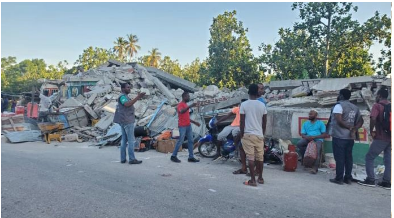
Des bâtiments entiers ont été transformés en gravats – ADRA Haïti
