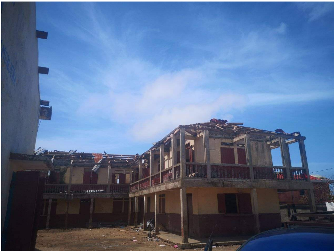
Dégâts du cyclone Batsirai © FJKM
