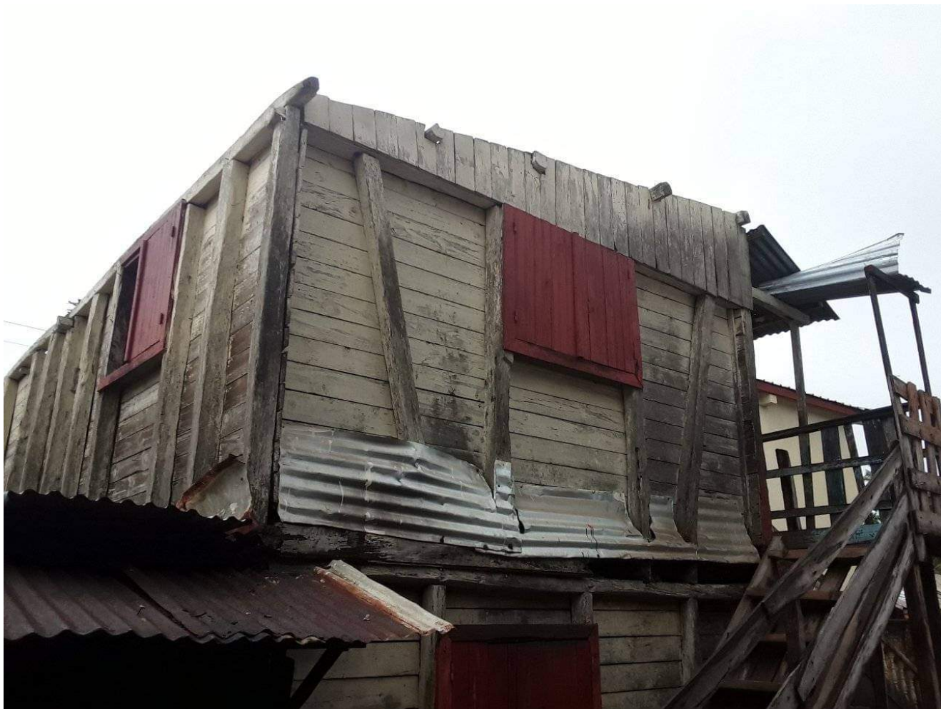
Dégâts du cyclone Batsirai © FJKM
