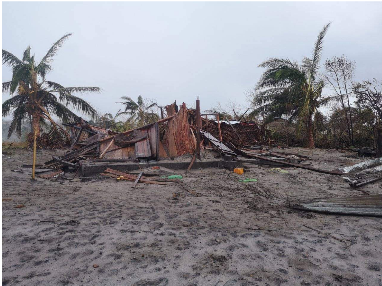
Dégâts du cyclone Batsirai © FJKM
