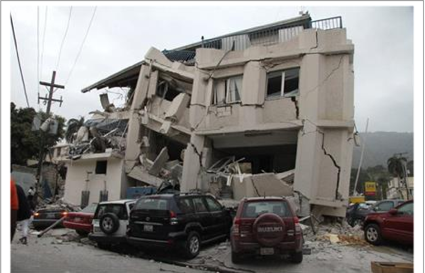
Bâtiment endommagé par le séisme © FEPH
