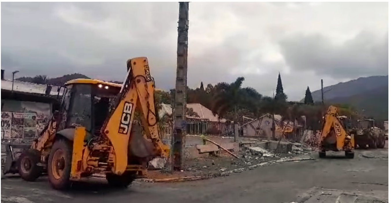
Bulldozers dégagent les décombres après les émeutes en Nouvelle-Calédonie © DR
