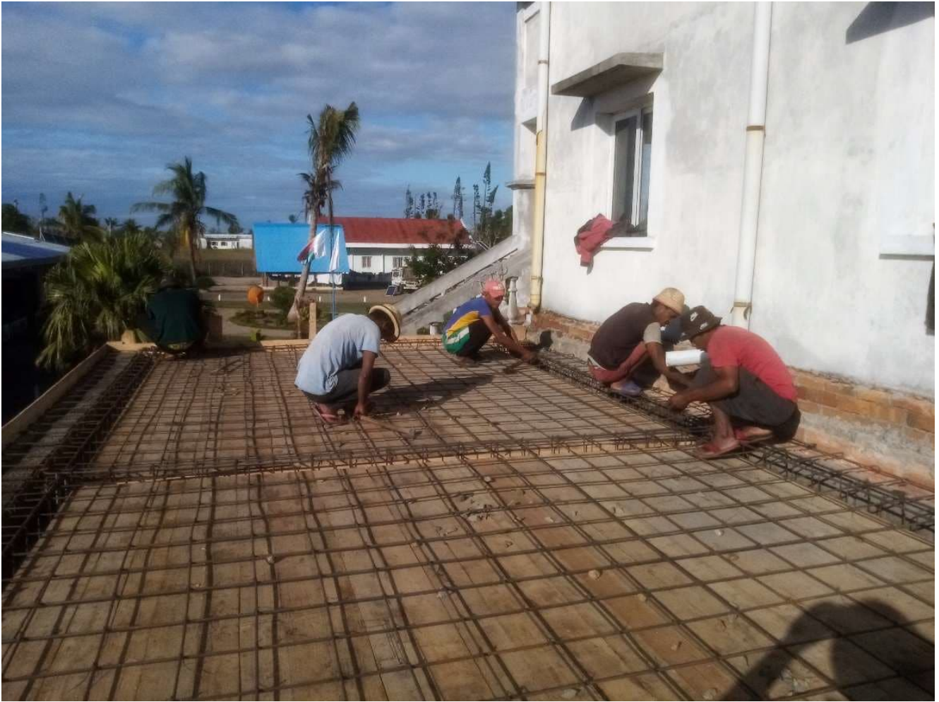
Mise en place d'une dalle de béton sur un bâtiment du Catja © ADRA
