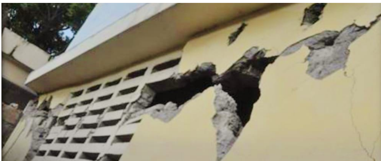
Une vue des dégâts dans une école de Gros Morne © FEPH
