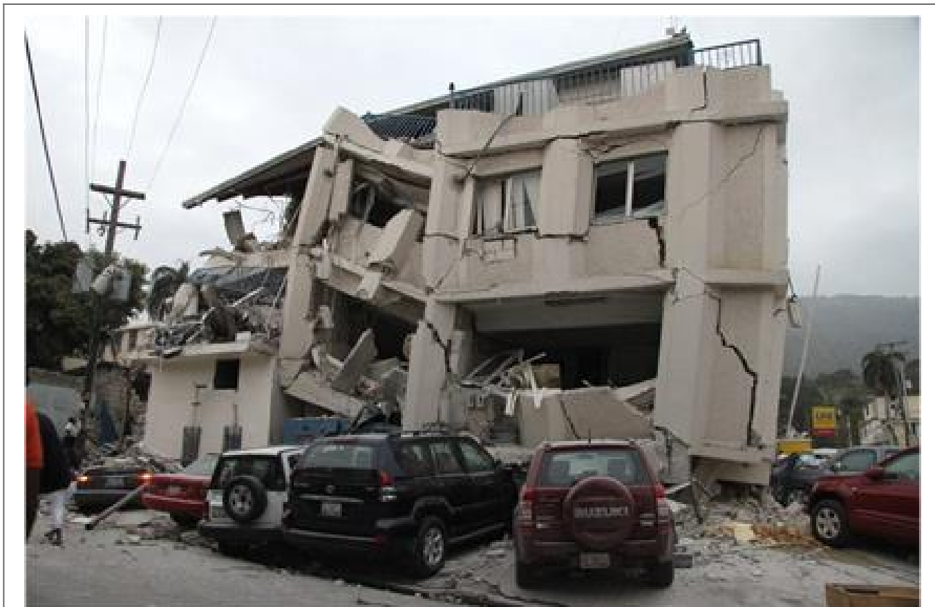
Bâtiment endommagé par le séisme © FEPH
